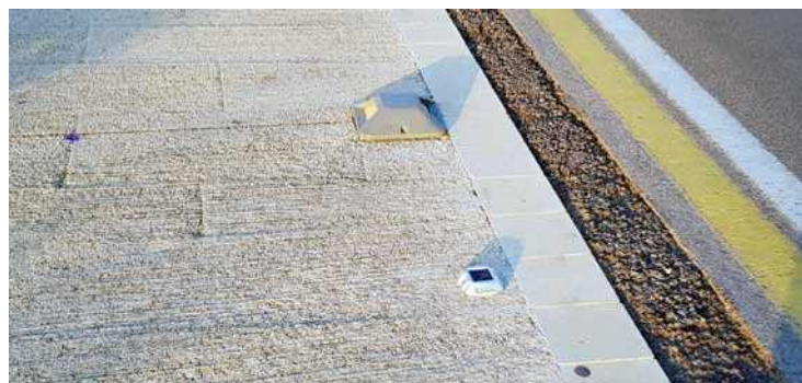
Las balizas fueron robadas tras ser recientemente instaladas
