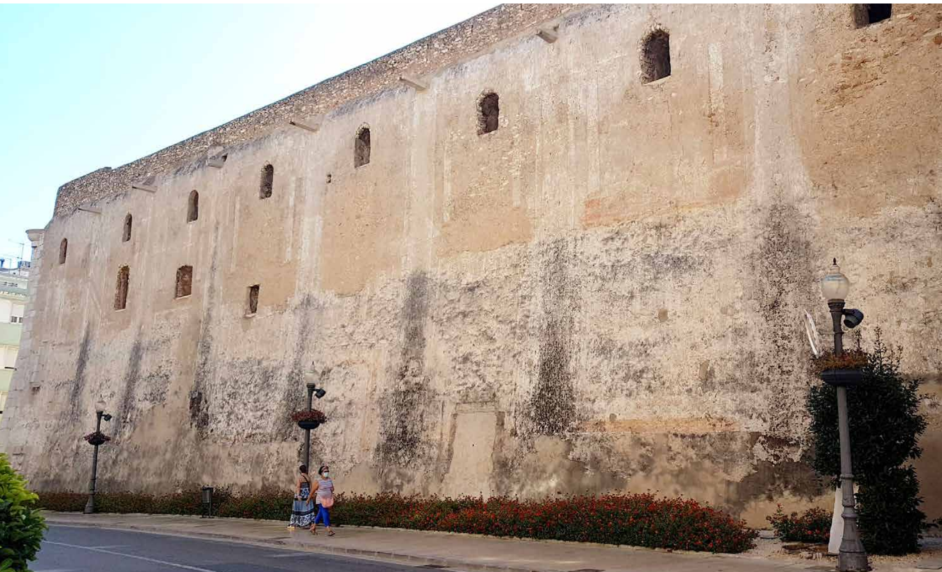
Estat actual dels esgrafiats de la façana de l'església. En pocs anys l'humitat i els fongs han ennegrit les pintures fingides i pràcticament ni s'aprecien
