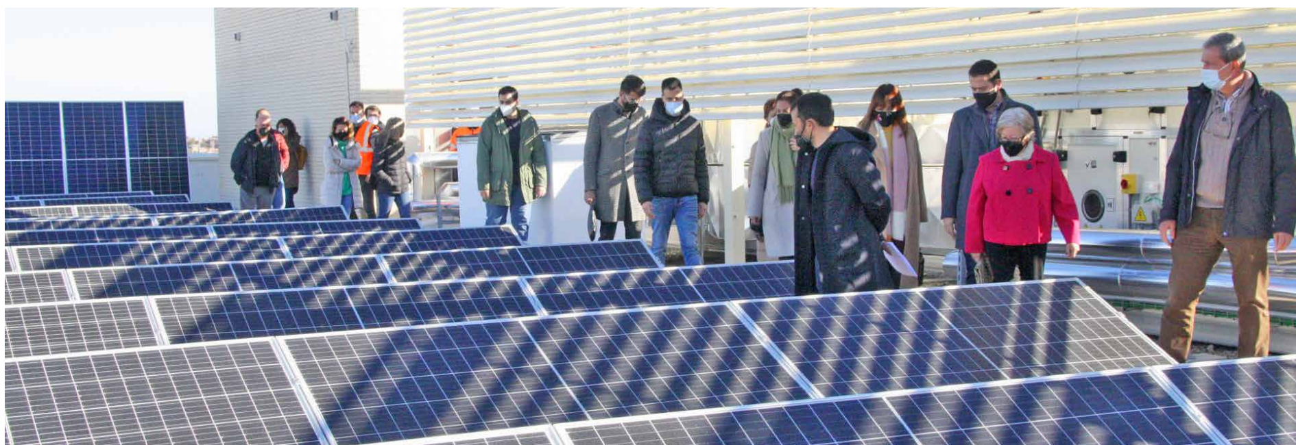
Eficiència energètica. El sostre del centre, ple de plaques fotovoltaïques. Els vidres de les aules són de 16 mm i l'aïllament, de qualitat
